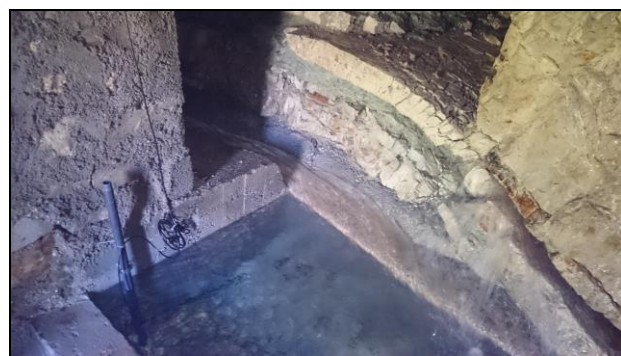
Fig.5.3 – Particolare dell'interno dell'opera di captazione e delle venute d'acqua al contatto con il livello impermeabile.
