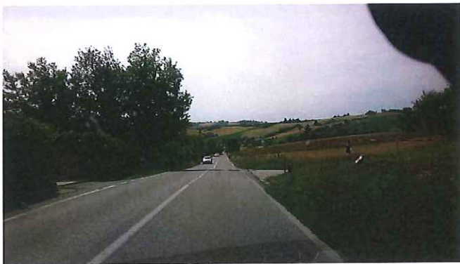
51 - Km 10+600 S.P. 362 JESINA AVVALLAMENTO.jpg
