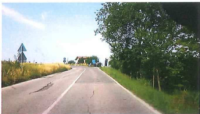
17 - KM 04+150 S.P. 502 DI CINGOLI AVVALL. E LESIONI.jpg
