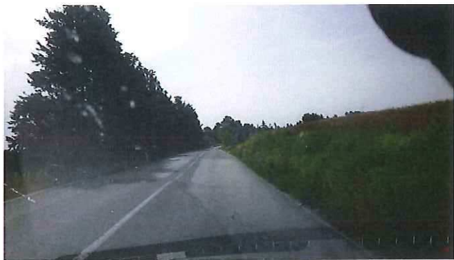
20 - KM 04+600 S.P. 502 DI CINGOLI AVVALLAMENTO.jpg
