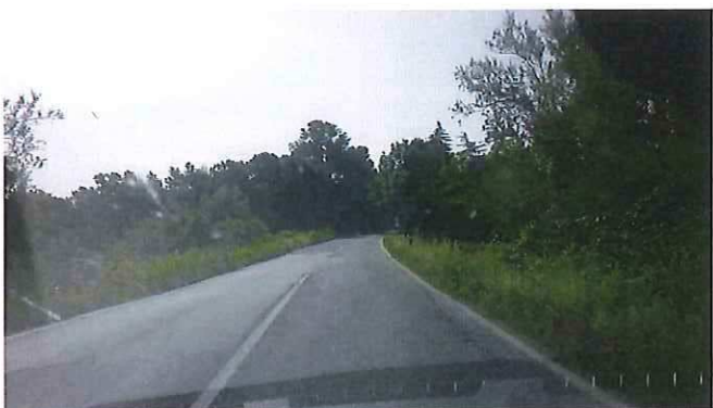
21 - KM 04+800 S.P. 502 DI CINGOLI AVVALLAMENTO.jpg
