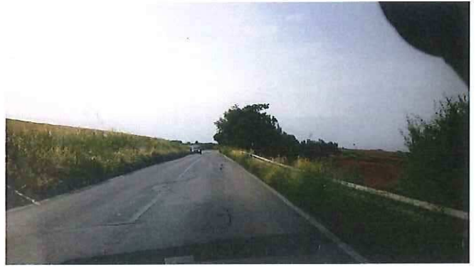
28 - KM 05+400 S.P. 502 DI CINGOLI CEDIMENTO LATO DX.jpg
