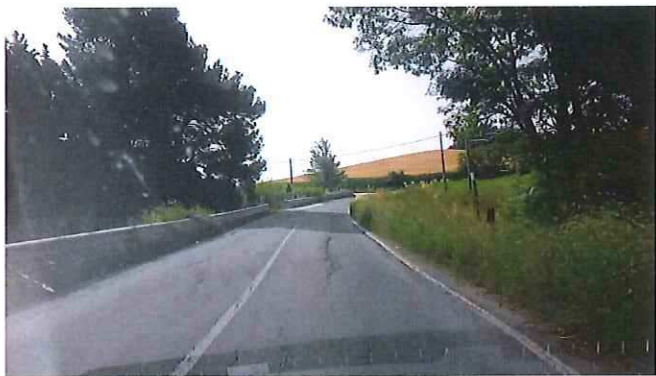
22 - KM 04+900 S.P. 502 DI CINGOLI AVVALLAMENTO.jpg
