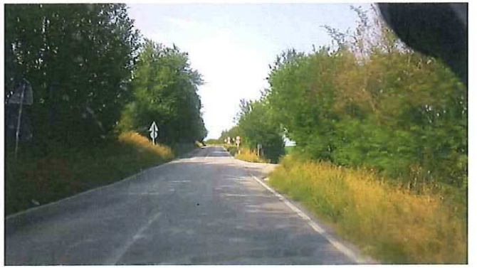
08 - KM 02+900 S.P. 502 DI CINGOLI AVVALLAMENTO.jpg
