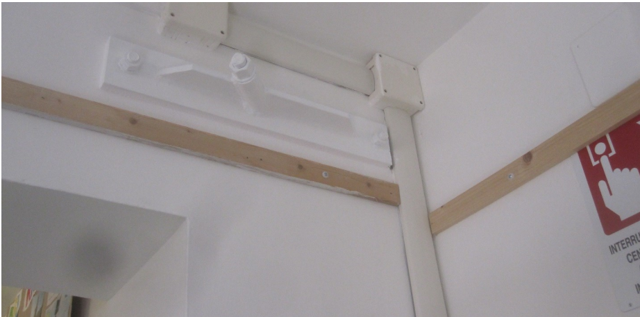
Particolare delle canalette esterne del nuovo impianto elettrico e di uno dei capochiave dei tiranti inseriti per il rafforzamento antisismico.
