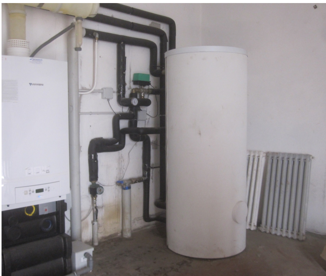
Nuova caldaia a condensazione
