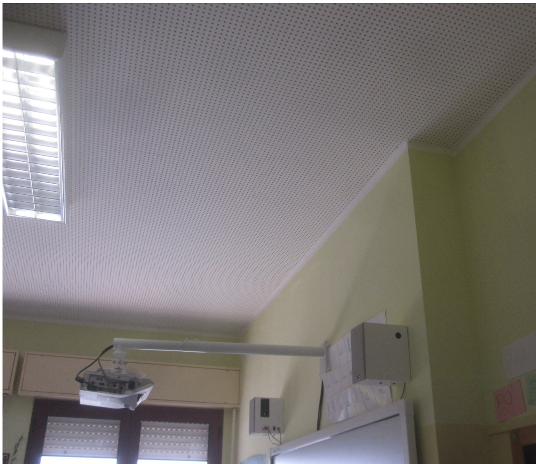
Solai anti sfondellamento
