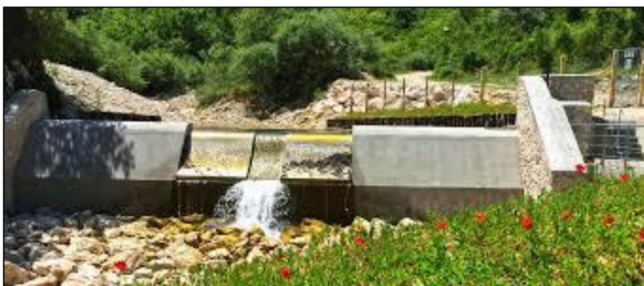
Mini centrale idroelettrica sul fosso Gorgolungo - Jesi (AN)
