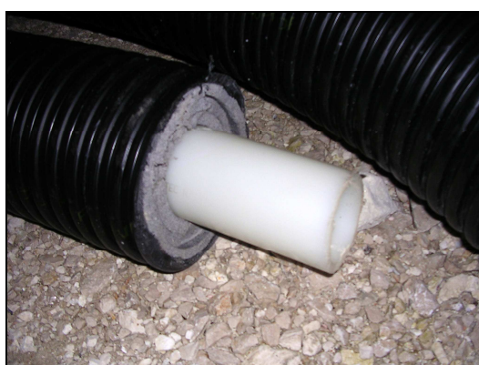
Figura 10 – Particolare della tubazione coibentata per il teleriscaldamento
