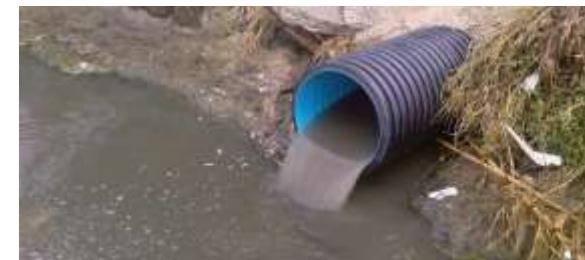
Scarichi industriali e artigianali diretti nelle acque superficiali (ma anche in quelle sotterranee)
